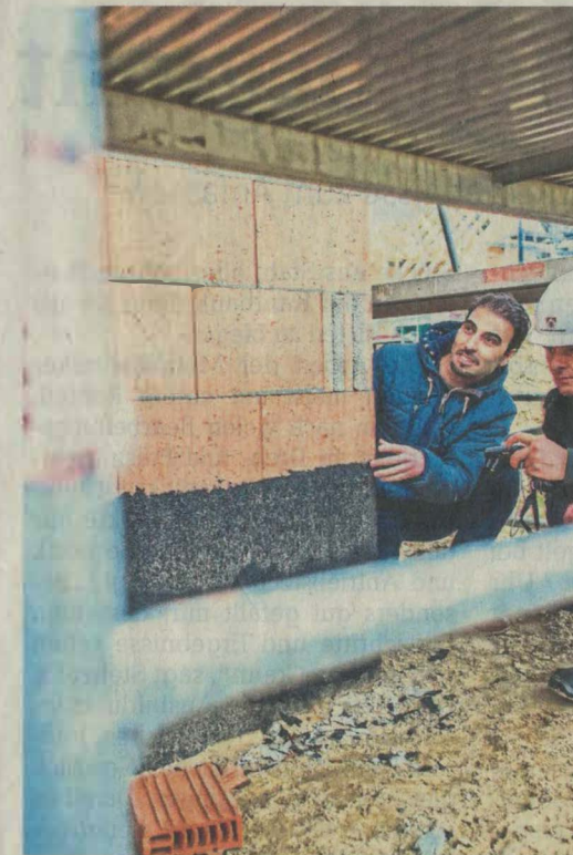
Wenn es im Keller feucht wird, ist in vielen Fällen die Abdichtung die Ursache.
